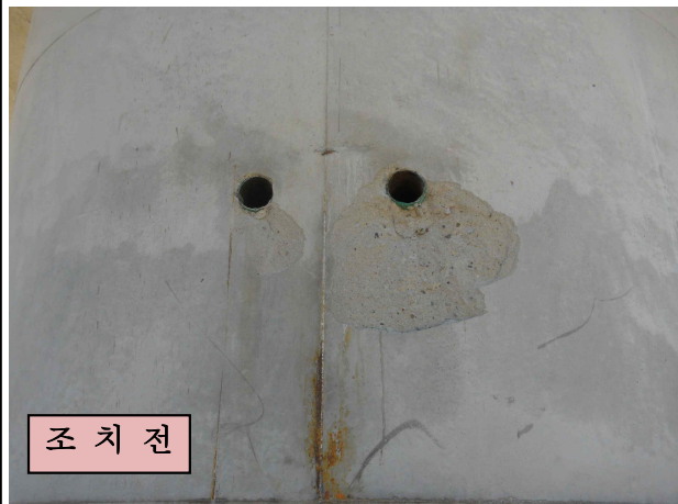
<P10 앵커홀 주변 콘크리트파손>
