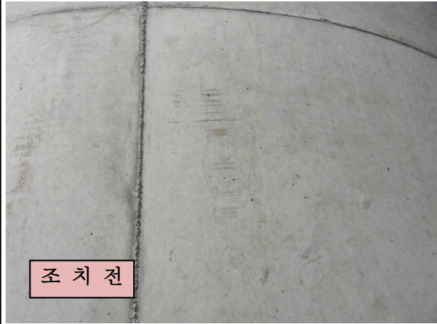
<P3 기둥부 수직균열>
